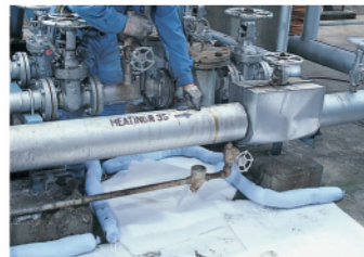
作業中の漏油に
